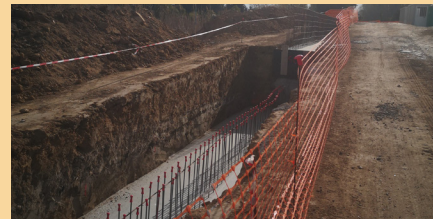
Fondations avec son ferrailage en attente de l'élévation du mur. Cette partie est en continuité avec la partie en attente de coulage.
