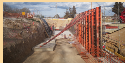
Mise en place des panneaux ou banches en vue du coulage des murs en béton. Il s'agit de la partie située dans le sens Taillades/Cavaillon
